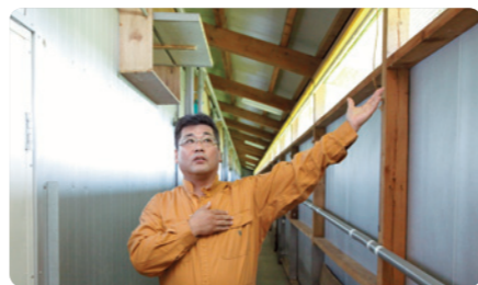
豚舎の空調管理のための窓 コンピューターで管理されます
